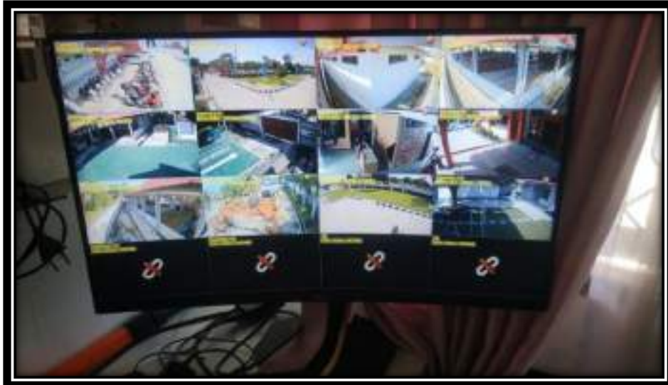
Layar monitor CCTV
