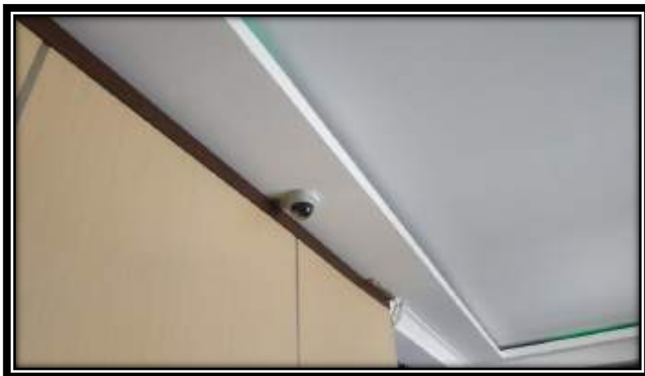
CCTV yang berada di ruang tamu
